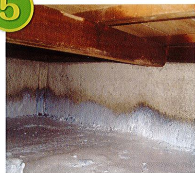
散布中 基礎と床下の間に隙間ができないよう散布します。
